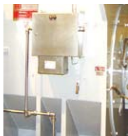
Dispositivo de pressurização
